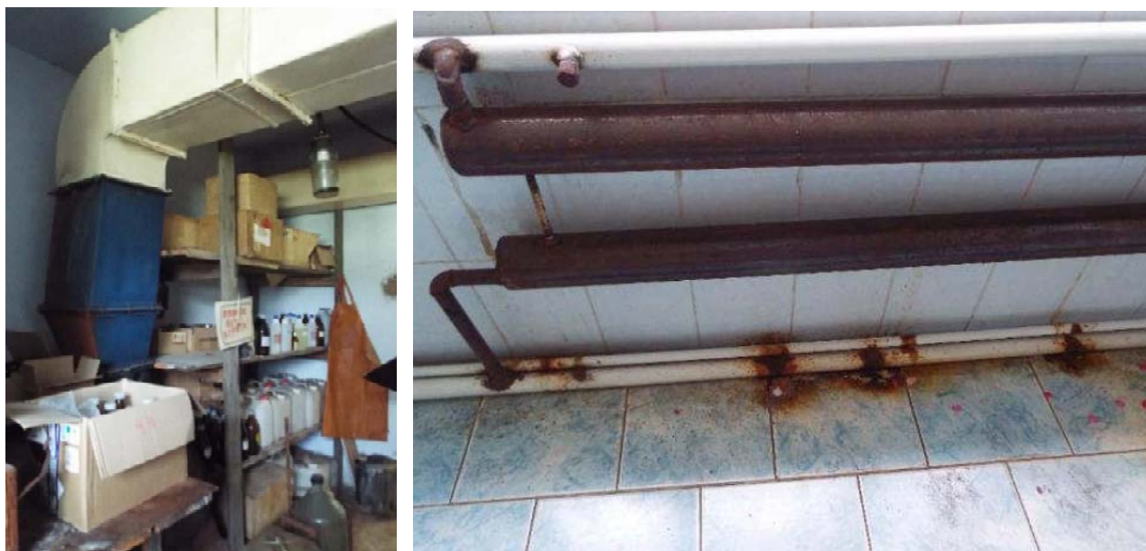
Рис. 5. Системы отопления и вентиляции неисправны
