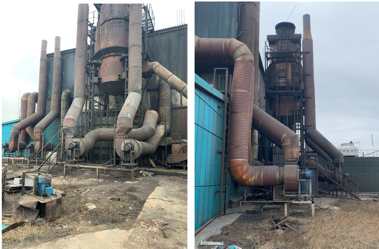
Рис. 1. Коррозия вентиляционного оборудования и воздуховодов
