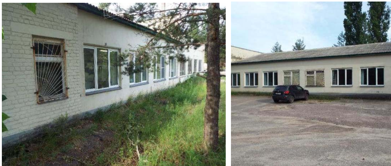
Рис. 6. Повреждение отмостки по периметру здания
