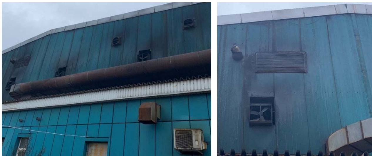
Рис. 2. Коррозия элементов и участков вентиляционной сети
